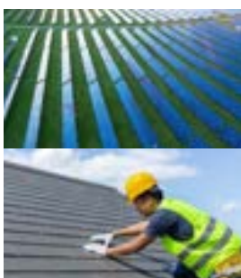
Figuur 7 • Rendement is essentieel: Grootschalige implementatie van Zon-PV vereist nauwkeurige inzet van de beperkte ruimte in ons land. Iedere procent (absoluut) verhoging van het rendement scheelt ruim 25 km 2 in het oppervlak dat nodig is om een vermogen van 100 GW p op te wekken. 25 km 2 is de oppervlakte van de stad Delft.
